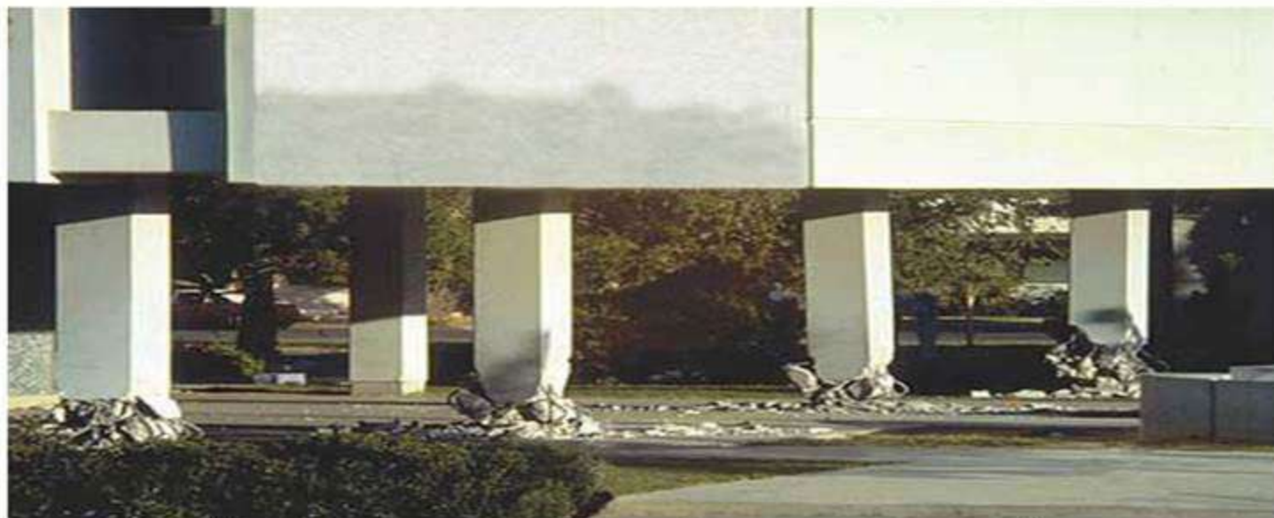
Примеры разрушений зданий после землетрясений магнитудой 6.7 и 6.4 в Калифорнии
